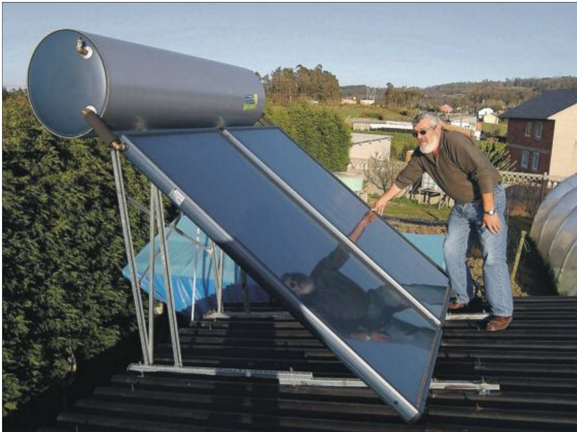
Modesto Lamas, vecino de San Sadurniño, junto a las placas solares instaladas en el tejado de su casa de Igrexafeita. / GABRIEL TIZÓN
